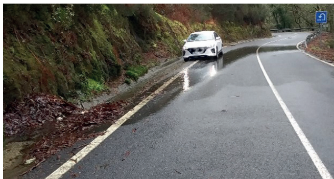
Figura 23. Sumidero de drenaje transversal en cuneta, tapado por las hojas. El agua cruza la carretera.
