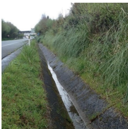
Figura 2. Cuneta triangular con riesgo de vuelco (antes)
