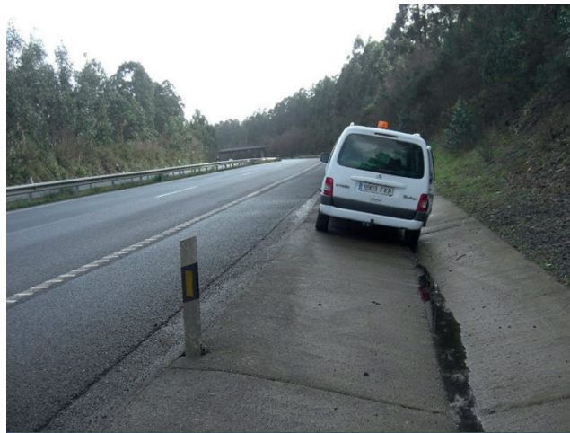
Figura 5. Cuneta de sección: 6H:1V + 4H:1V. Obsérvese la fuerte inclinación del automóvil del lado 6H:1V.
