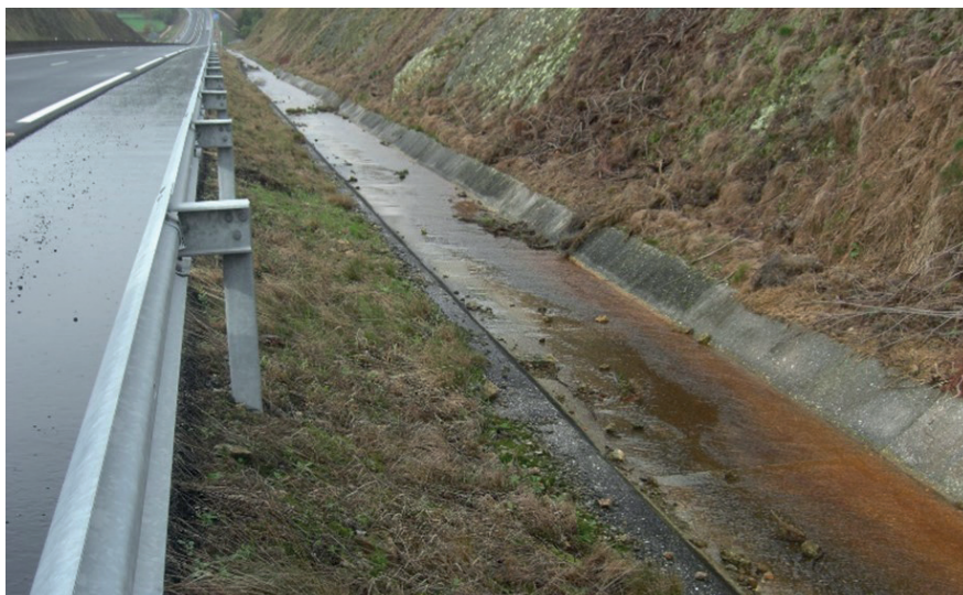
Figura 9. La barrera se coloca para proteger una cuneta absurdamente grande y profunda (obsérvese la escasa marca que el agua férrea ha dejado en la cuneta). Con el gran ancho existente entre la barrera y el talud hubiese sido muy fácil un rediseño "amigable" con una cuneta de seguridad 10H:1V
