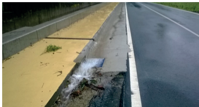
Figura 24. El caudal y velocidad del agua se salta el sumidero, una boca de buzón sería más eficaz.
