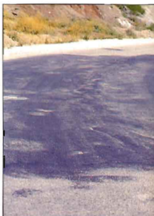
La mejora en el equipamiento y conservación de Foto 3: Carretera sin señalizar (Revista MOPU). Fot
