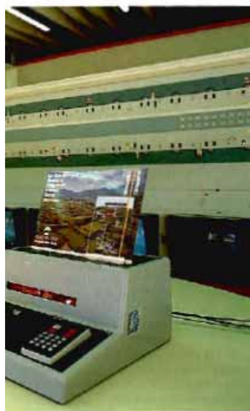
Centro de control.
