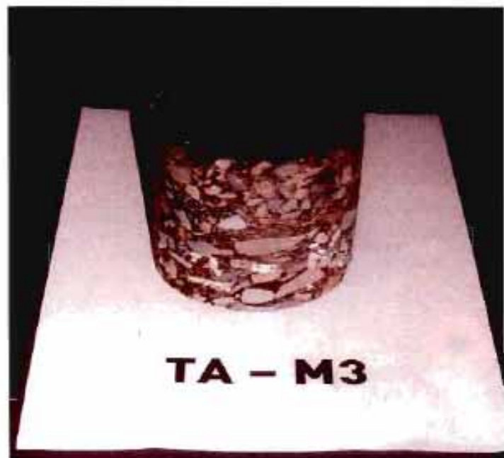
Testigo extraído en junta entre pavimento nuevo y antiguo.
