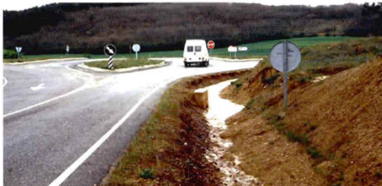
La erosión hídrica puede generar accidentes o agravar las consecuencias de los producidos por otras causas. En esta foto, los drenajes están atascados por sedimentos, procedentes de la erosión en los desmontes, y próximos al desbordamiento en un importante cruce de carreteras en Palencia.
