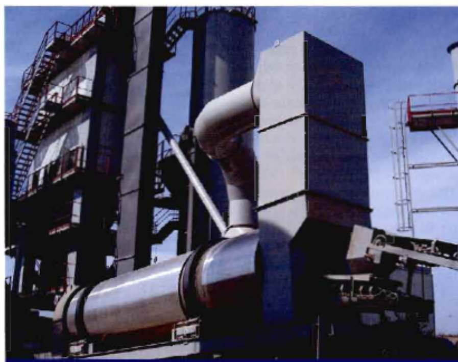
Fotografía 2: Central discontinua para la fabricación de mezclas bituminosas en caliente. En primer término, el tambor secador. La torre cilíndrica que puede observarse tras él alberga los silos de filler de aportación y recuperación.
