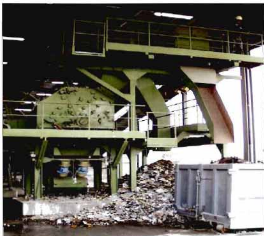
Central para el tratamiento de escorias procedentes de la incineración de residuos sólidos urbanos en Tarragona.
