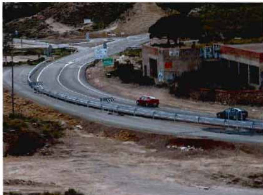
Foto 7. Curva corregida con balizamiento y defensa exterior.
