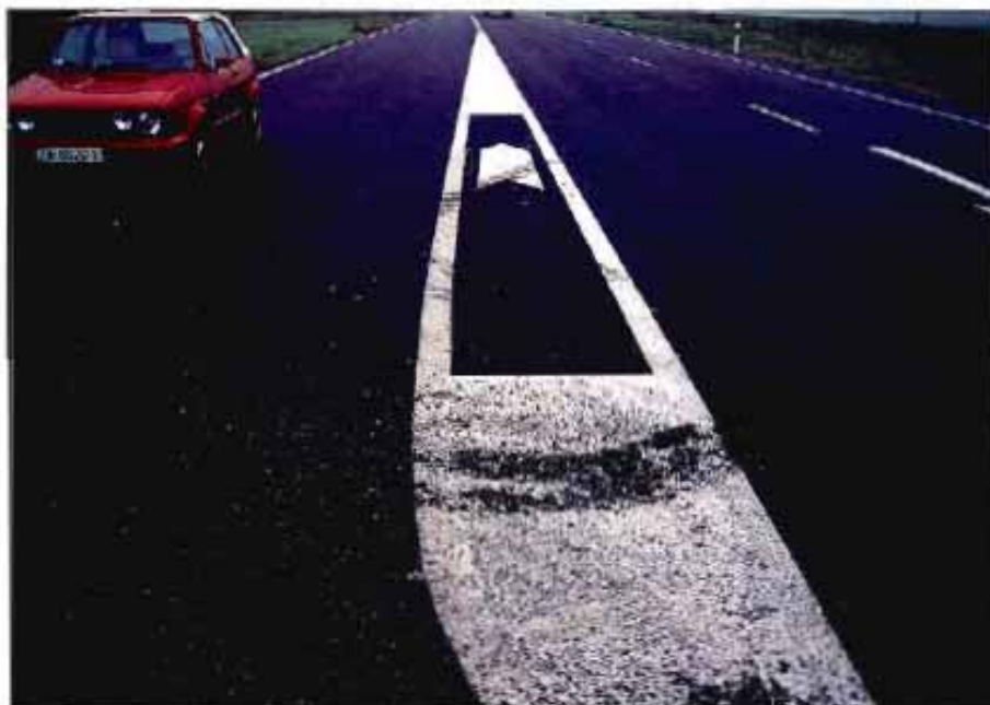
Deformaciones producidas por los giros en la calzada
