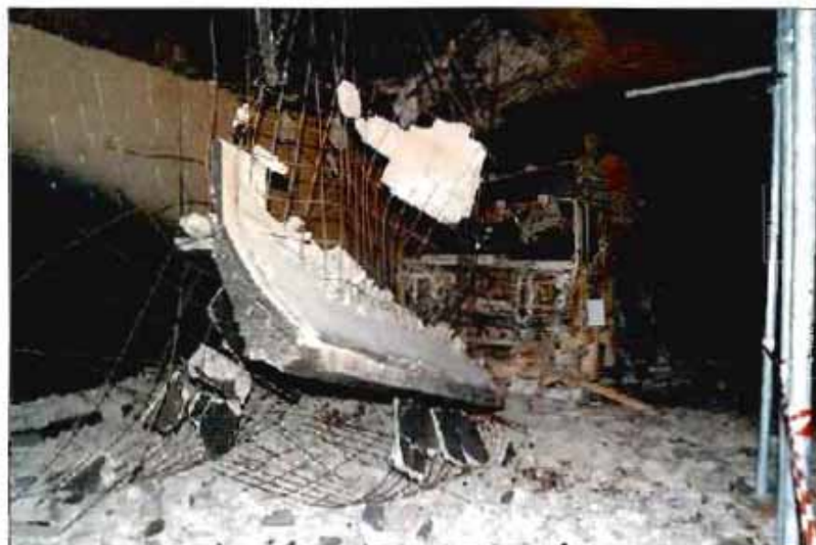
Los daños estructurales suelen causar serios problemas a la integridad del túnel.
