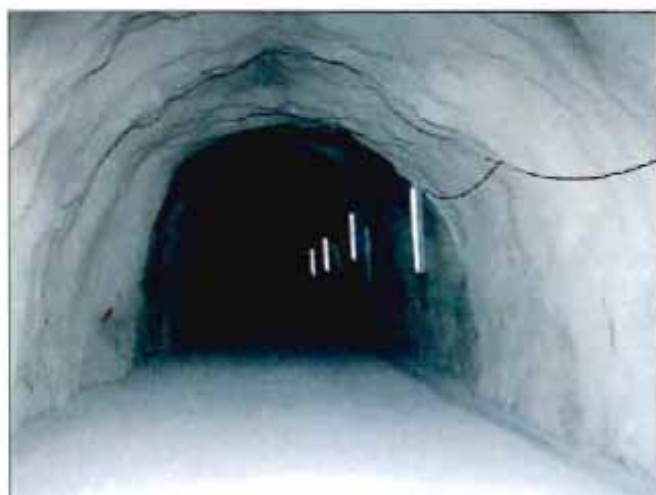
Las restricciones impuestas a los túneles varían considerablemente en función de su equipamiento.
