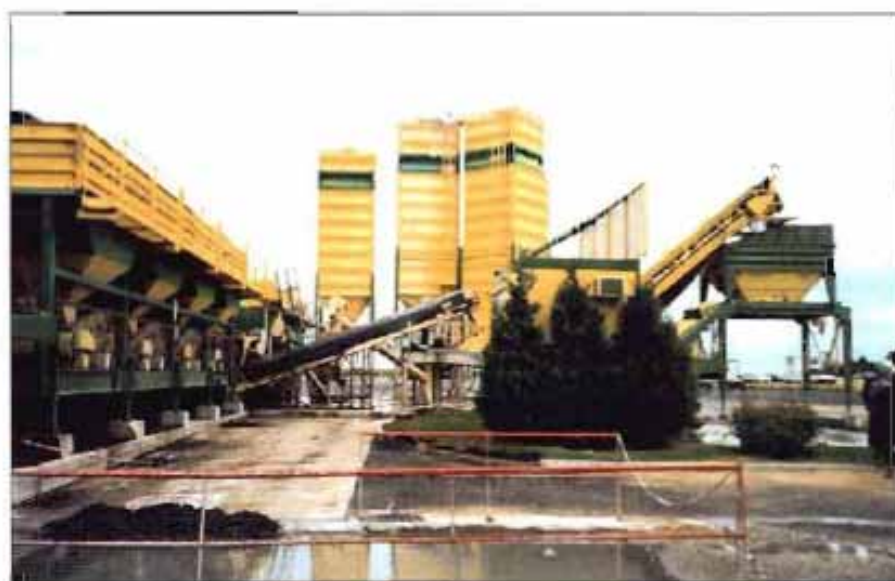
Central para la fabricación de gravas tratadas
