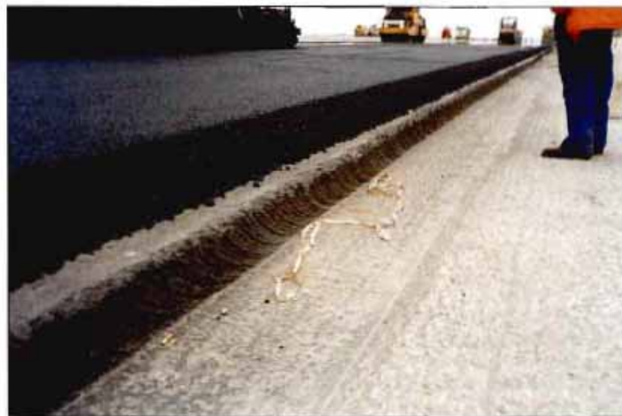
Borde de la base asfáltica. Se aprecia el corte de la junta con fresadora.
