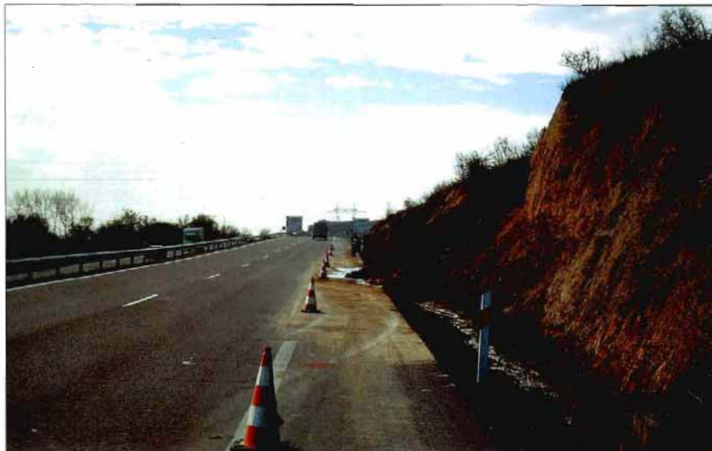
Foto 1. Deslizamiento de un desmonte en la autovía Valladolid-Palencia.
