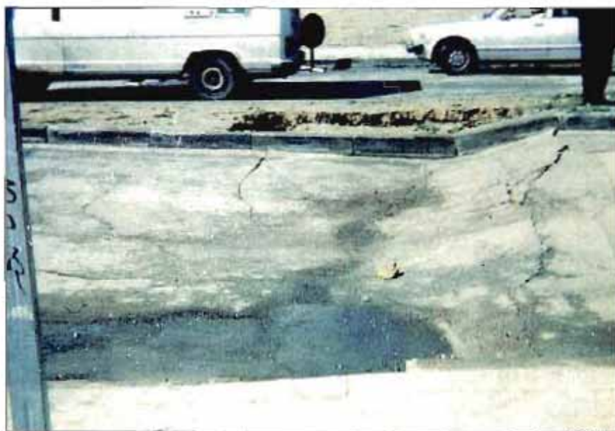
Figura 1a. Ejemplo de los defectos provocados por una ejecución inadecuada de los rellenos de las zanjas: hundimiento de calzada y acera.
