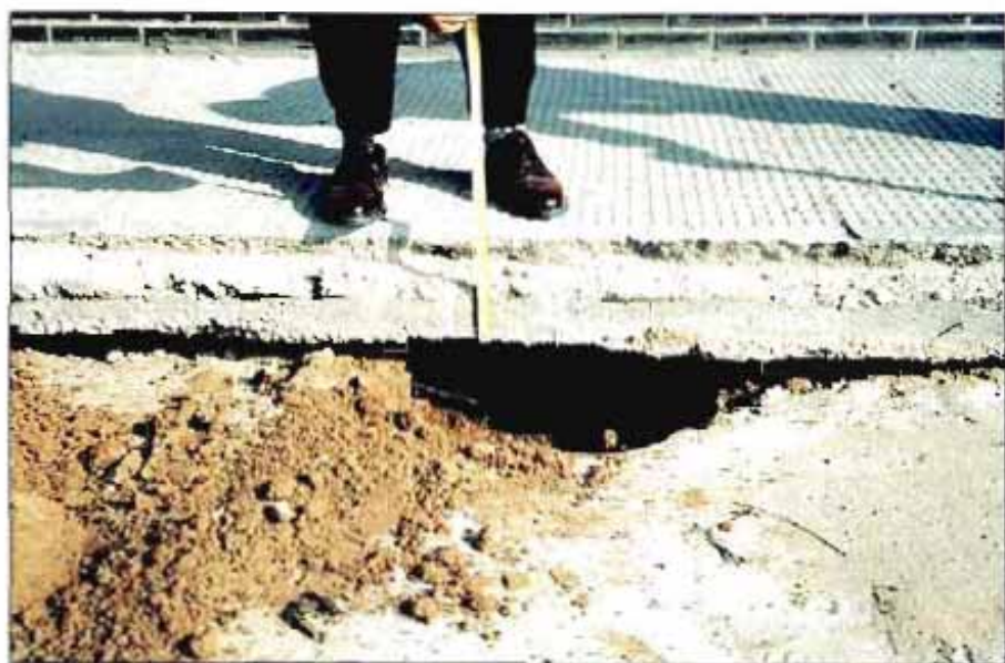
Figura 1b. Ejemplo de los defectos provocados por una ejecución inadecuada de los rellenos de las zanjas: socavón bajo la acera
