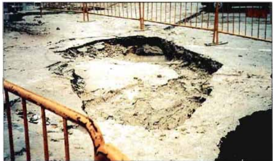
Figura 4. Socavón en la calzada.
