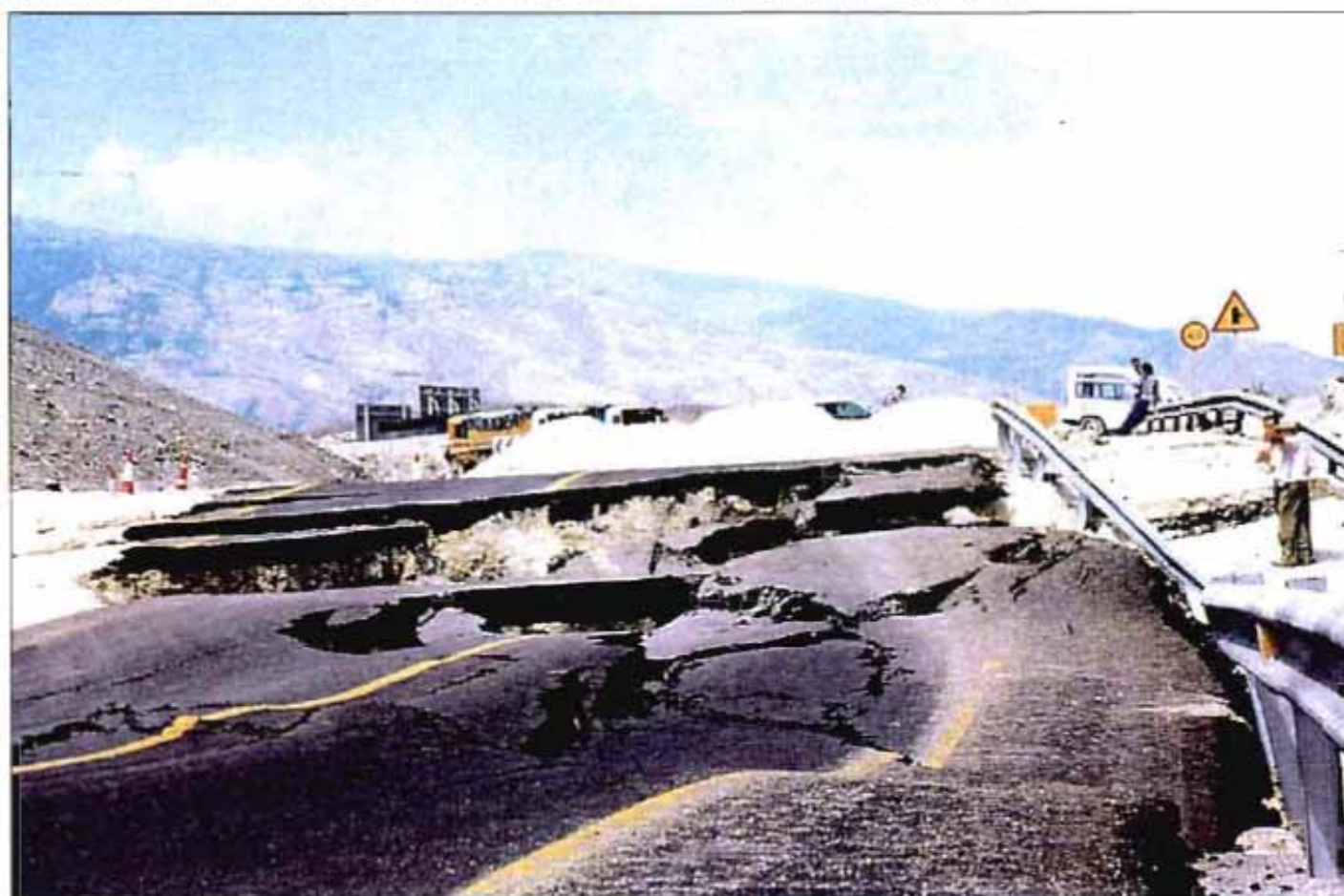
Foto 1. Hundimiento del firme por deslamiento del sustrato.
