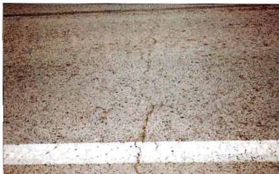
Evolución de la fisuración y de la degradación de un firme semirrígido. Fase I.
