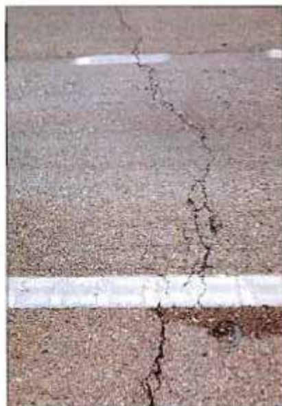
Evolución de la fisuración y de la deformación de un firme semirrígido. Fase 2.
