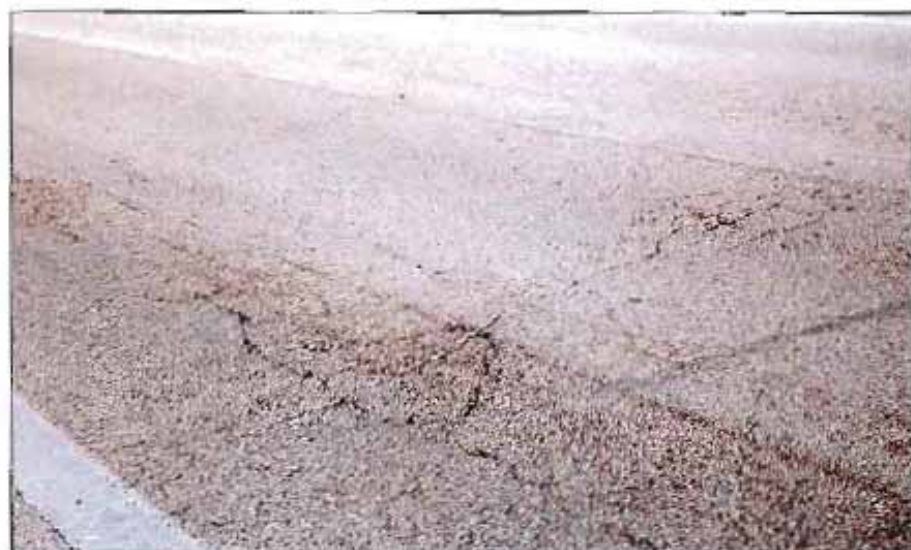
Evolución de la fisuración y de la degradación de un firme semirrígido. Fase 4.
