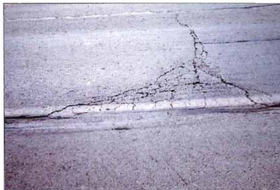
Evolución de la fisuración y de la degradación de un firme semirrígido. Fase 3.
