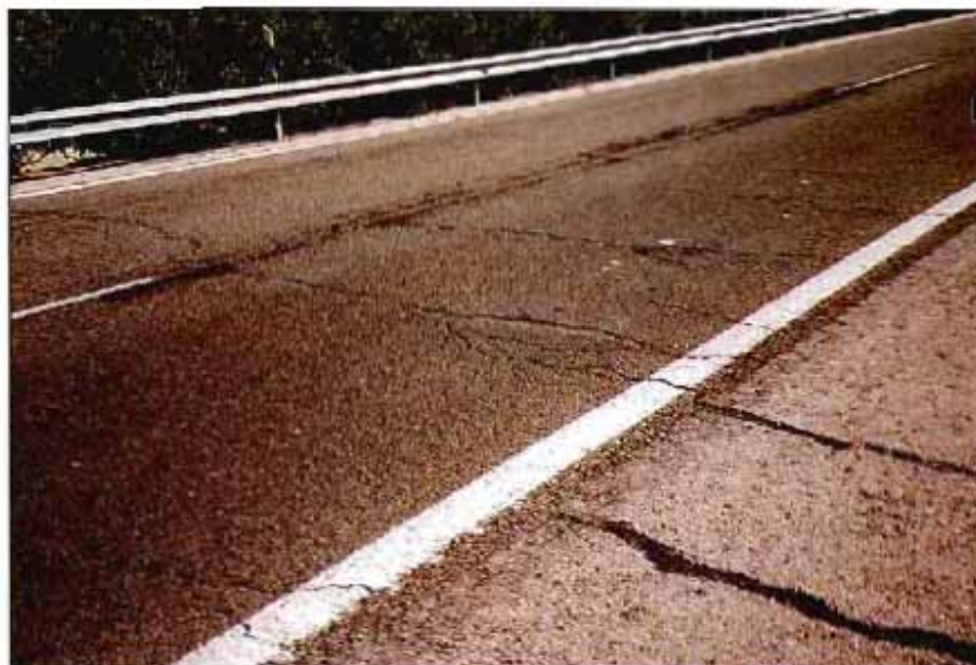
Evolución de la fisuración y de la degradación de un firme semirrígido. Fase 5.
