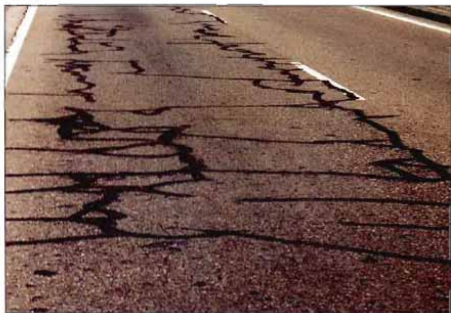
Firme semirrígido mostrando fisuras selladas por puentes
