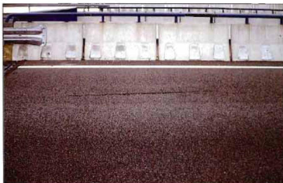
Figura 6. Fisuración a los 2 años de la mezcla porosa sobre el puente.
