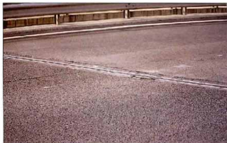
Figura 4. Pavimento de mezcla cerrada en el puente en una carretera pavimentada con mezcla porosa.
