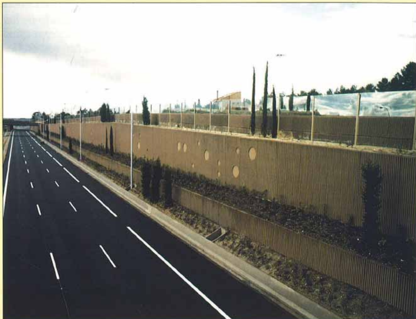
El tratamiento medioambiental también implica la colocación de pantallas fonoabsorbentes.
