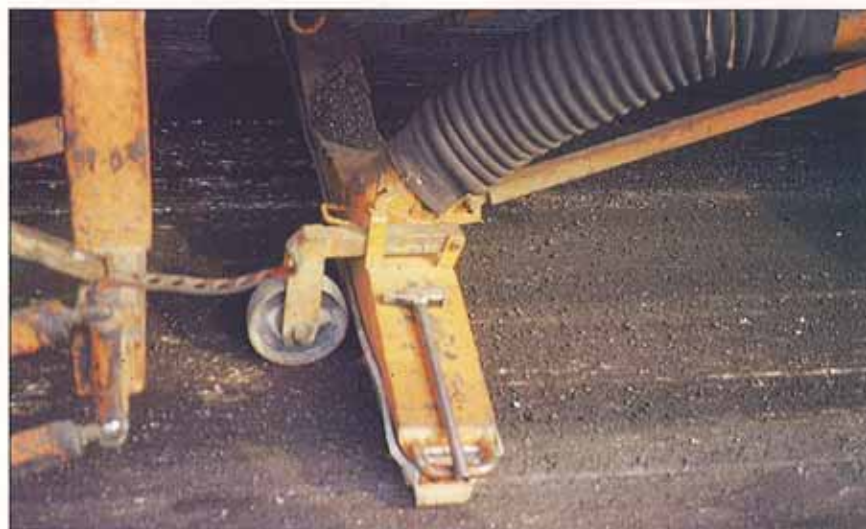
Aspiración de residuos.
