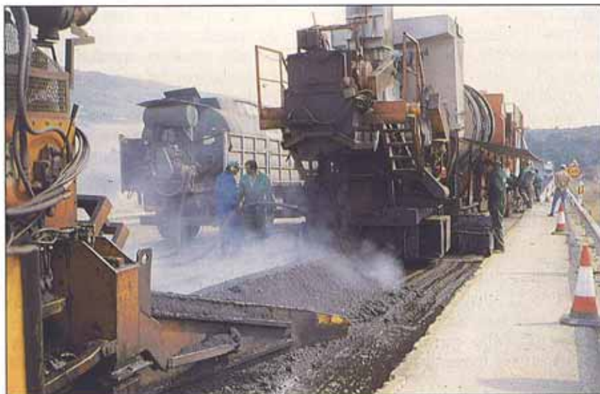
Salida del material regenerado y carga de la ART durante la operación (gasóleo, regenerante, y emulsión).
