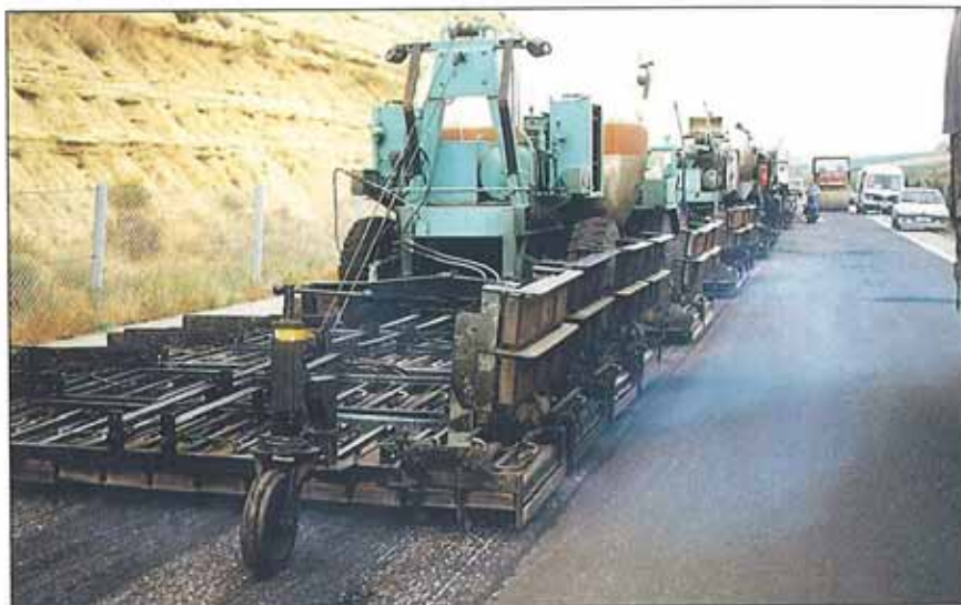
Termorregeneración con paneles radiantes.
