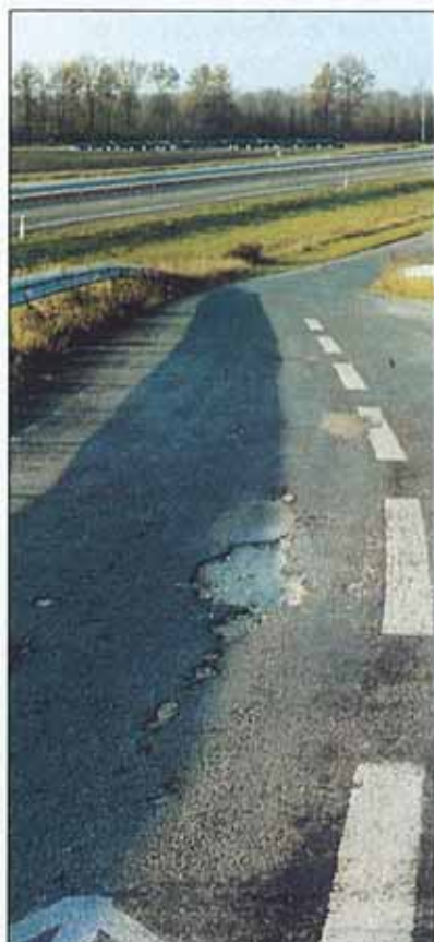
Los deterioros se dividen en superficiales y estructurales.
