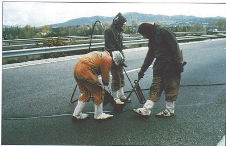
Ponteo de fisuras
