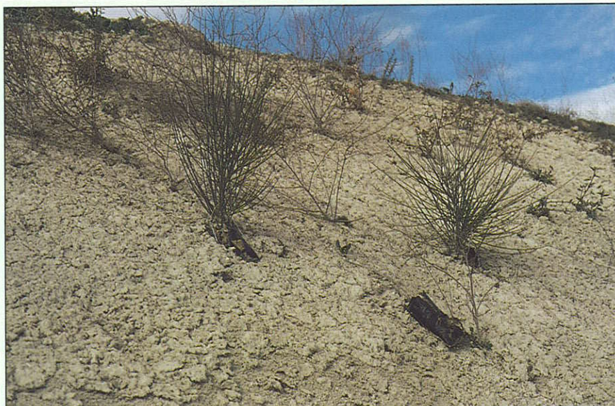
Foto 6. La densidad de plantación no es suficiente para proteger la superficie del terreno y estabilizar el desmonte. Los deslizamientos provocan el arrastre de las plantas
