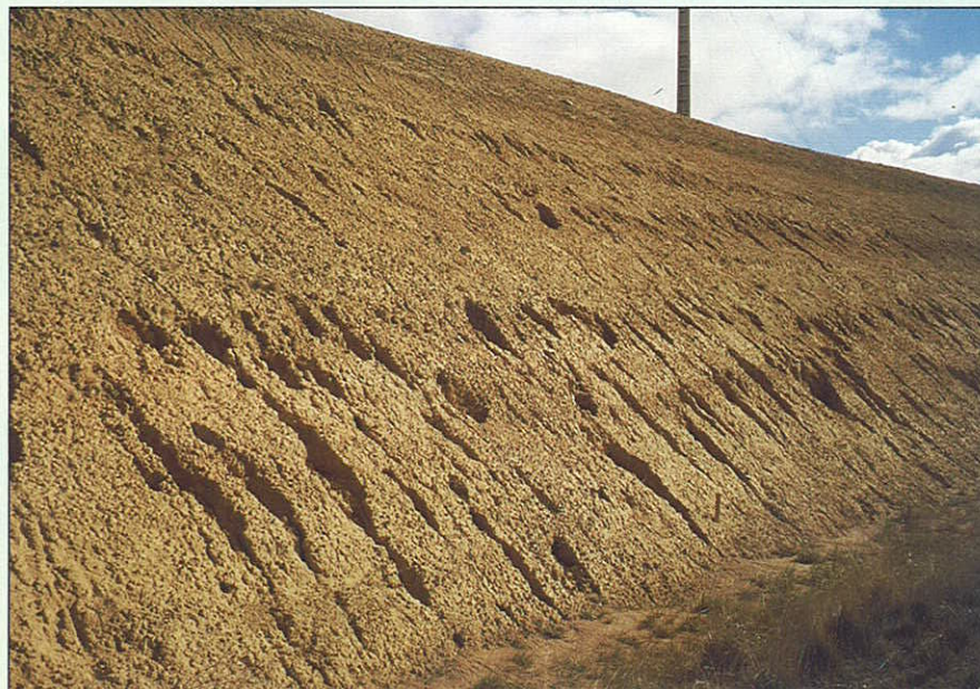
En la foto nº2 se observan claros procesos de erosión en regueros y la deposición de sedimentos al pie del talud: en consecuencia, la cuneta se aterra
