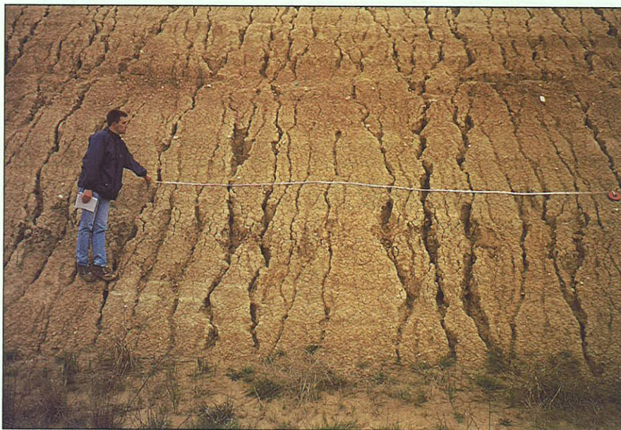
Foto 5. Los regueros se inician desde la cabeza del talud. Su intensidad es preocupante
