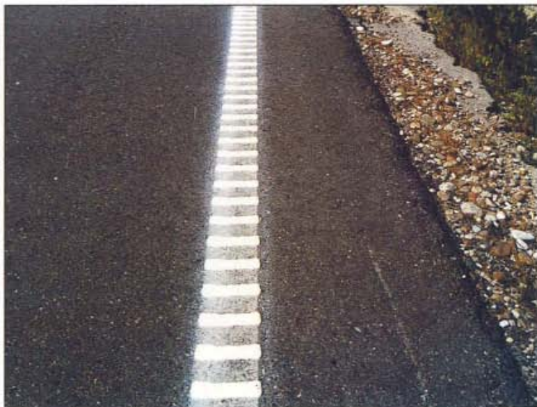
Figura 10. Aspecto de la señalización horizontal en forma de perfiles.
