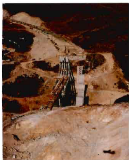
Viaducto en deslizamiento.
