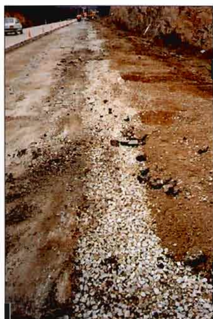
Foto 3. Detalle de la zahorra drenante del arcén en Despeñaperros, al ser descubierta en 1991. (Obsérvese el buen estado del material).
