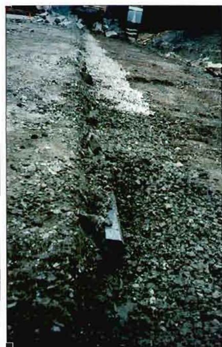
Foto 5. Detalle del dren y el tubo colector, colmatado por los finos de la explanada. (1991).
