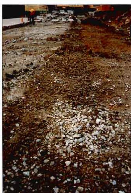
Foto 4. Detalle de la zahorra drenante del arcén, en la variante de Despeñaperros. El material drenante aparece totalmente colmatado por los finos de la explanada. (1991).
