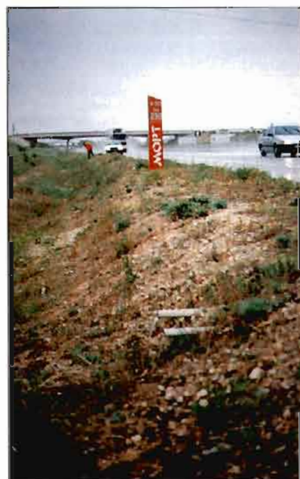
Foto 2. Salida de agua a través de los tubos ranurados en un día de lluvia, en N-301, La Roda-Albacete. (Cortesía de D. Isidoro Picazo).
