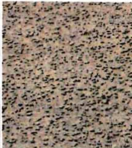
Aquí tenemos un clásico ejemplo de envejecimiento superficial (pérdida de betón, de finos, etc.)
