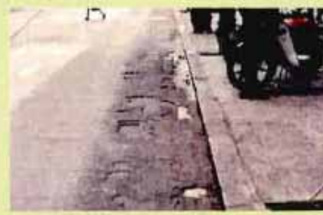
Peladuras de capa de rodadura.
