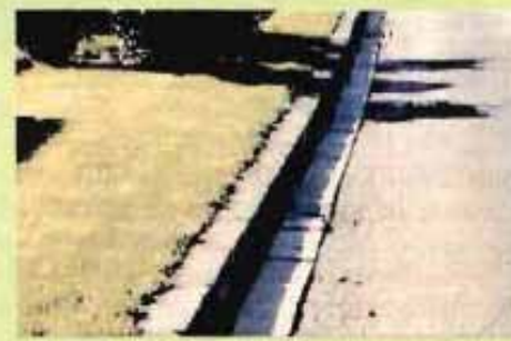
Fallos de base con existencia de parterres contiguos.
