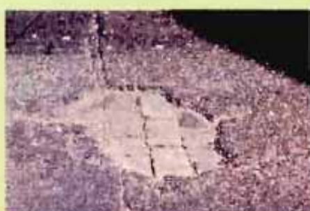
Peladuras de recubrimiento sobre adoquinados.
