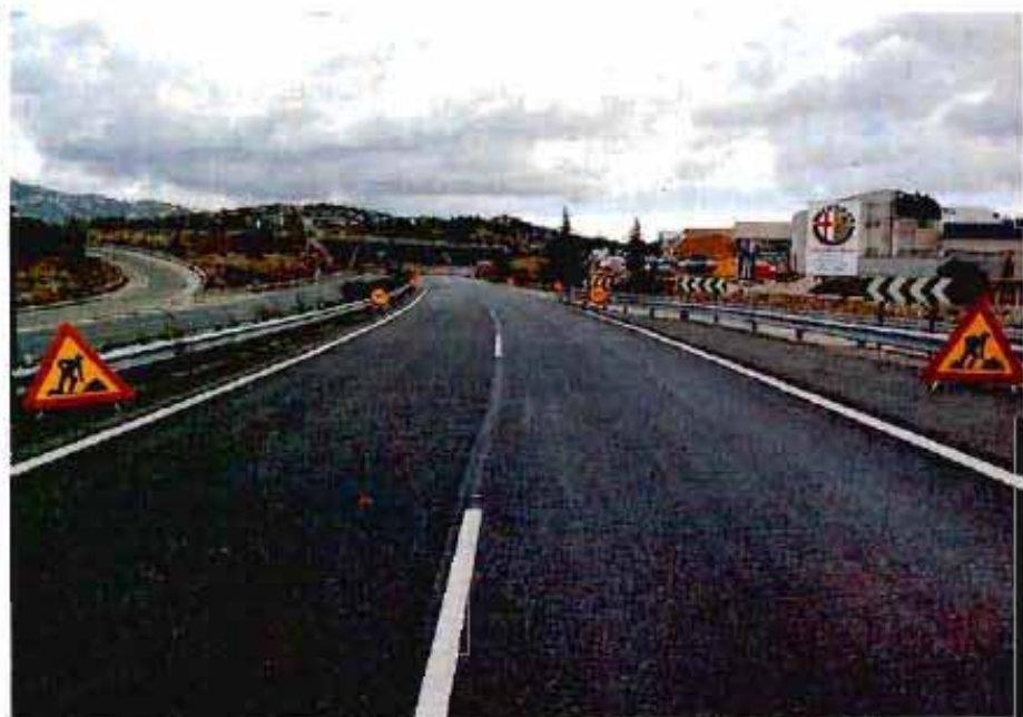
Pavimento drenante y permeable.
