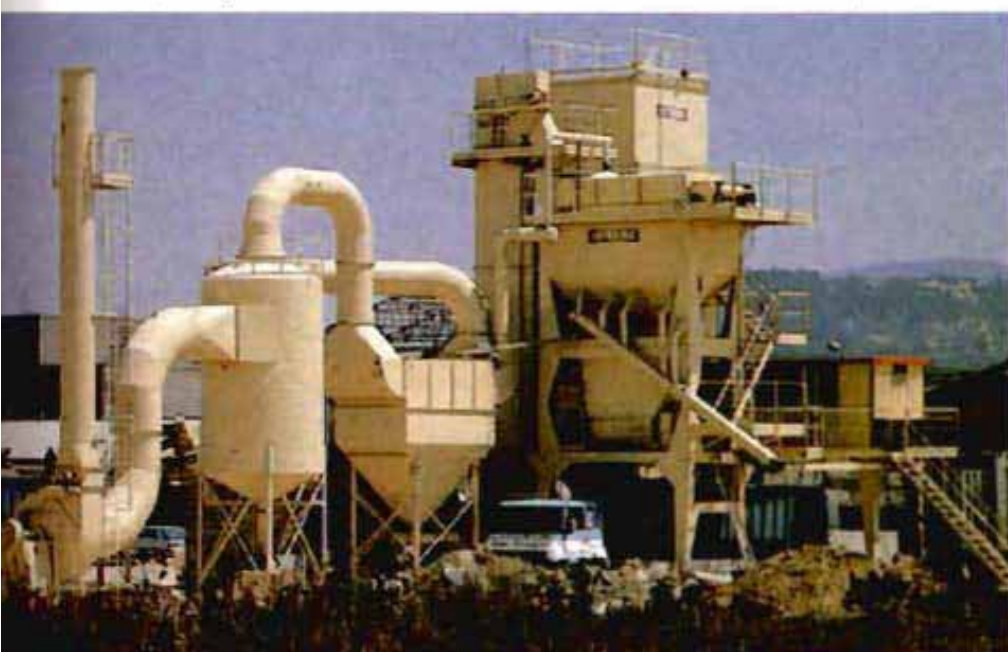
Planta asfáltica Discontinua.
