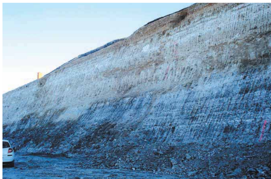
Desmante en materiales yesíferos. Se aprecia la granulometría de todo uno del material en el pie del talud
