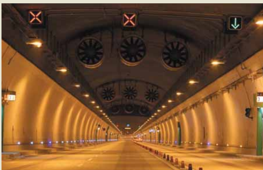
Vista interior del túnel. Zona de aceleradores. Un carril de bajada y dos carriles de subida.
