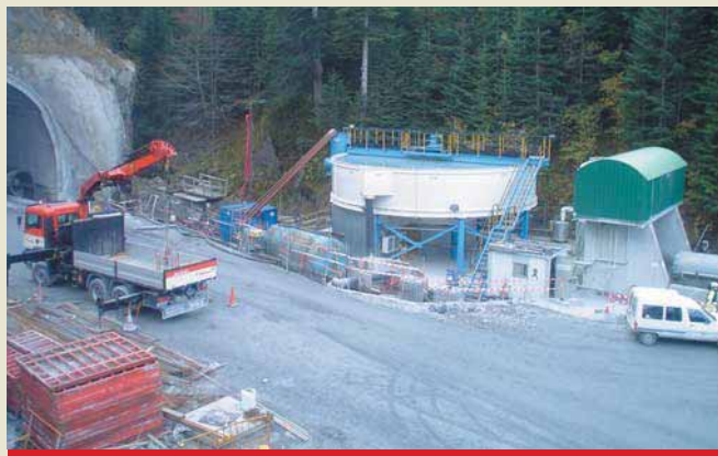
Planta de tratamiento de aguas de la boca norte con una capacidad de tratamiento de 1300 m 3 /h.
