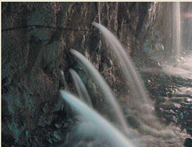
Detalle de agua en el interior del túnel, a veces, con presión.
