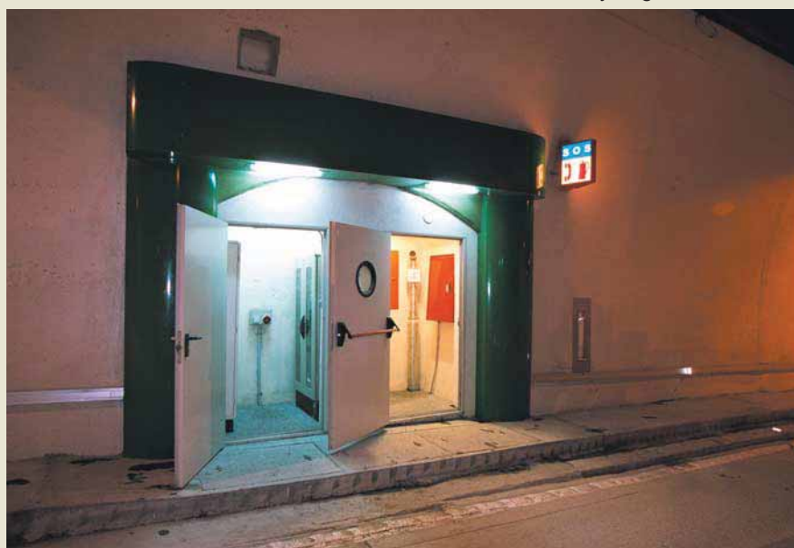
Detalle de equipamiento de un nicho de seguridad.
