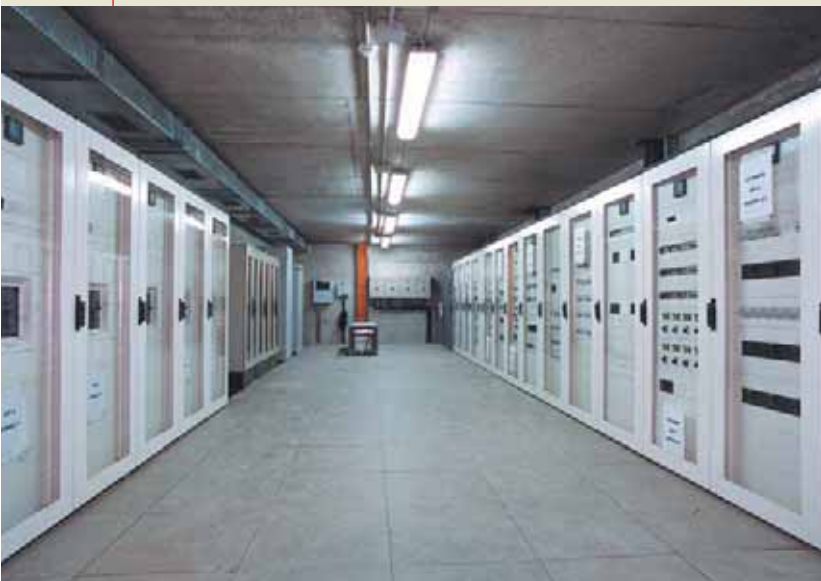
Centro de transformación de M.T. situado en la boca Norte.
