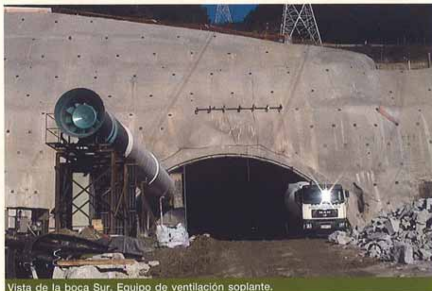
Vista de la boca Sur. Equipo de ventilación sopla.
