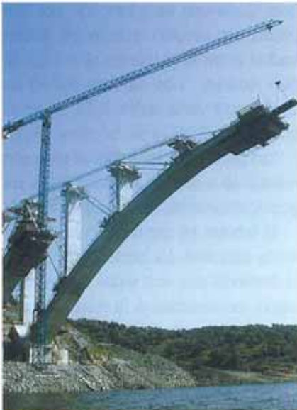
Detalle de una grúa trabajando cerca de su límite de utilidad.
