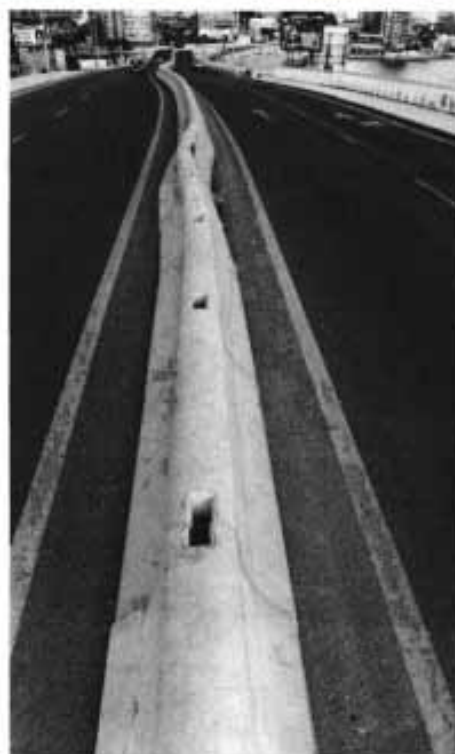
Dificultad de transmisión de esfuerzos en las barreras prefabricadas.
