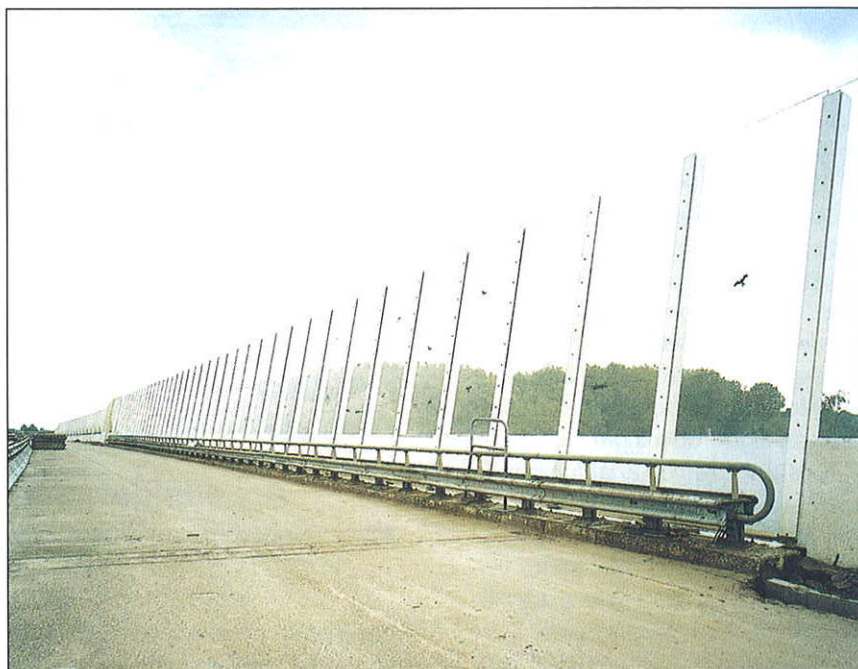
Ejemplo de pantalla antirruido formada por planchas acrílicas.
