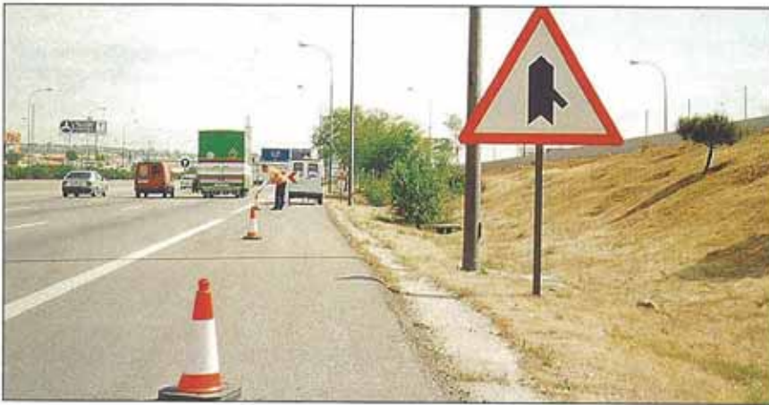
Es necesario mejorar la señalización durante la ejecución de las obras.
