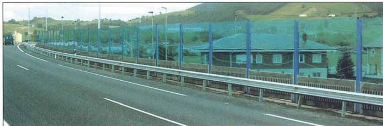
Disposición de pantallas antirruido en las inmediaciones del enlace de Tanos.
