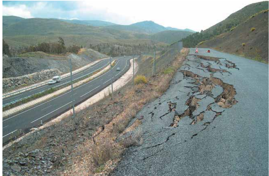
Autovía A-92. Tramo Huéneja-Las Juntas, km 350. Deslizamiento a mitad de la altura en talud en esquistos meteorizados y replegados.
