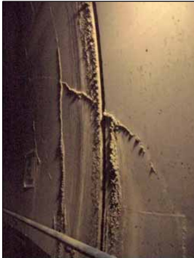
Figura 14.- Eflorescencias en una junta de retracción del revestimiento del túnel de Lilla causadas por filtraciones a través de la bóveda
