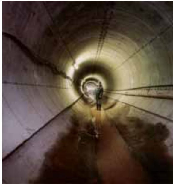
Figura 4.- Filtraciones en un túnel hidráulico construido con dovelas
