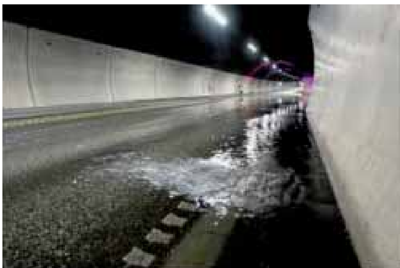
Figura 2.- Inundación en el túnel de Oslofjord (Oslo)
