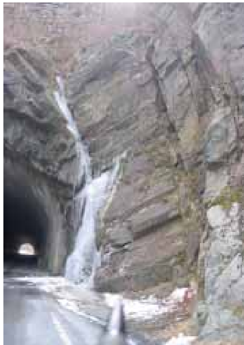
Figura 6.- Filtraciones a través de un dique basáltico en un túnel en Virginia
