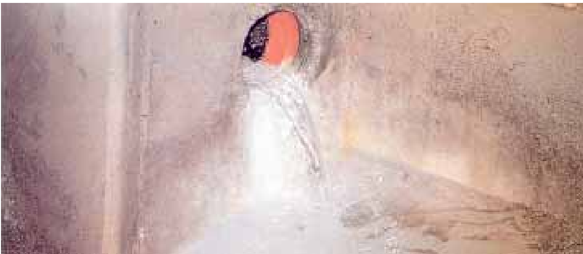
Figura 4.- Acumulación de calcita en un dren en un túnel.
