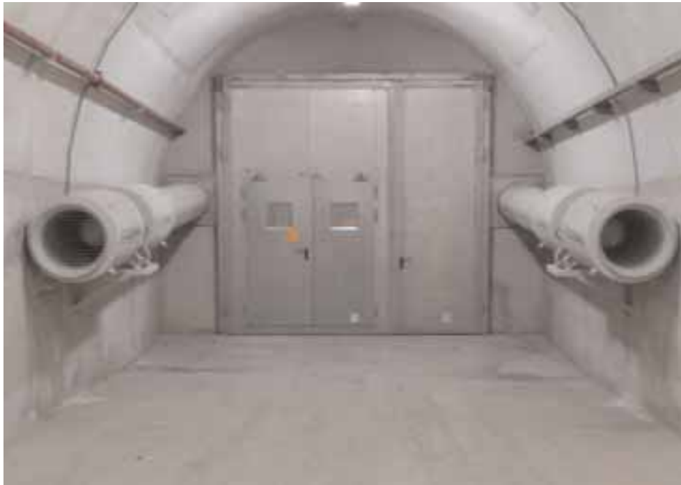
Cámara estanca en galería con ventiladores
