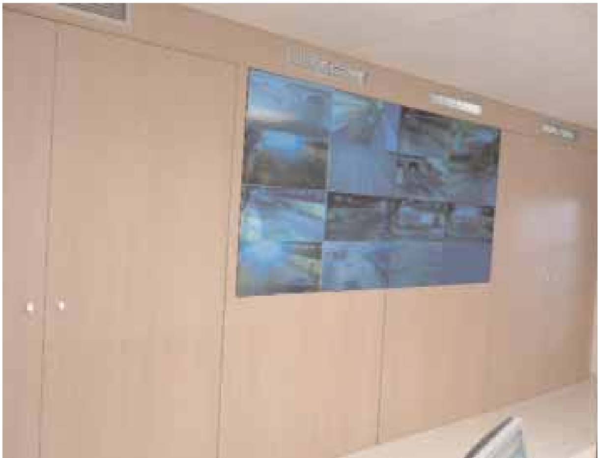
Centro de control - videowall)
