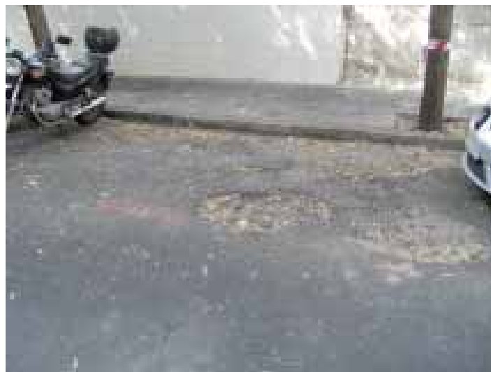
Figura 13 Daños causados en un pavimento urbano por el incendio de un automóvil
