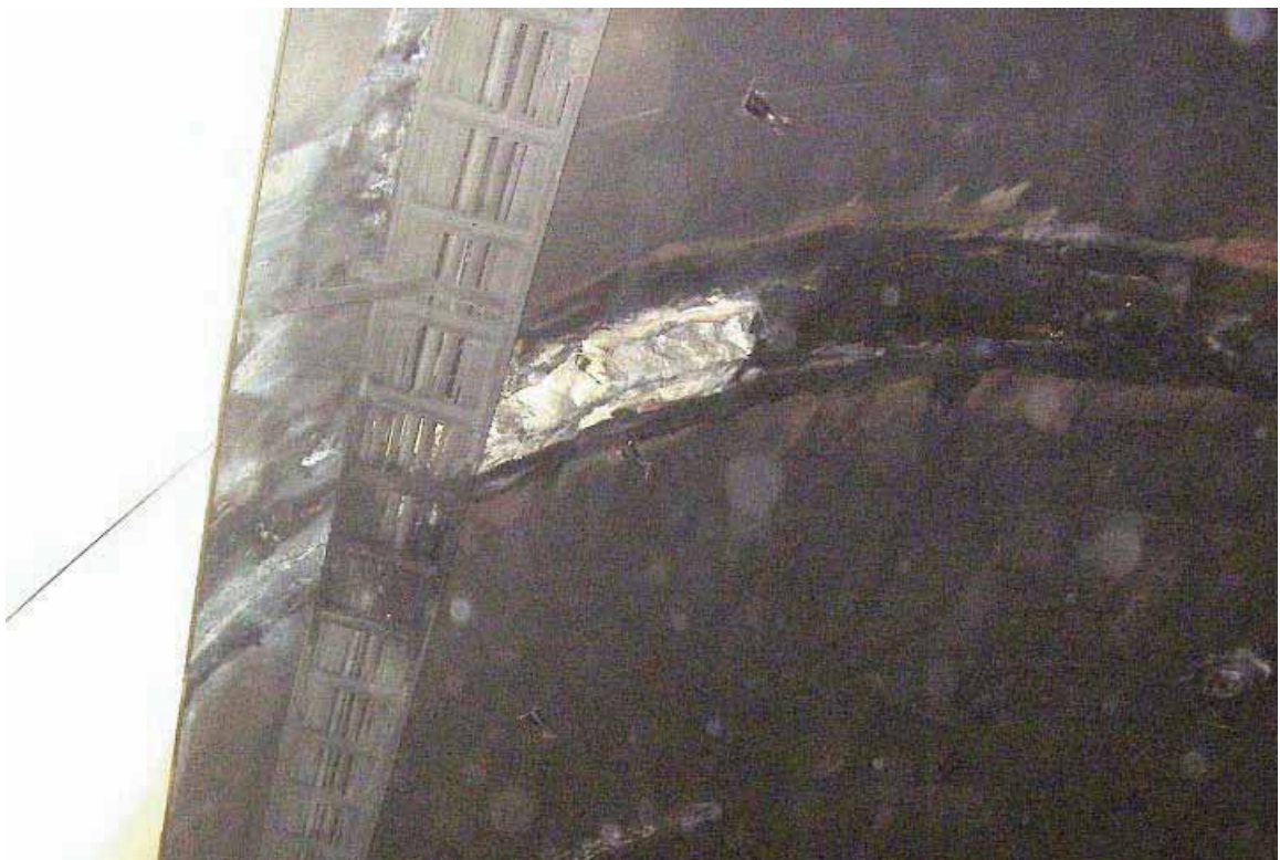
[Figura 2] Vista de junta en la que se ha desprendido un fragmento de banda elástica, antes del inicio de los tratamientos de impermeabilización.
