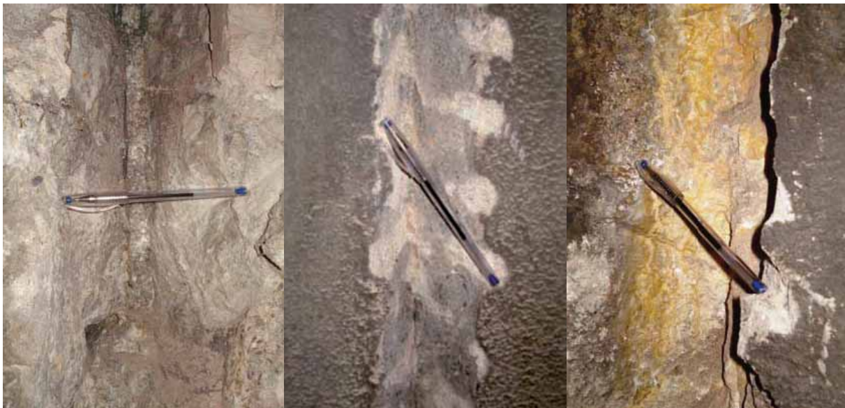
[Figura 4] Detalle del diferente aspecto que podían mostrar las juntas existentes entre módulos de revestimiento, tras el repicado, saneo y limpieza de las mismas.
