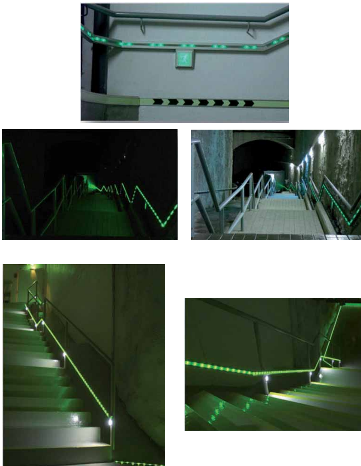
Figura 5.- Ejemplos de aplicaciones del sistema en recorridos de evacuación protegidos.
