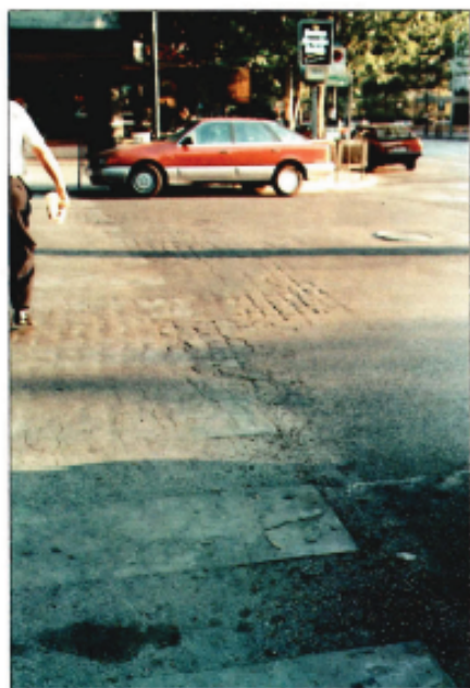
Estado del pavimento en cruce de calles.
