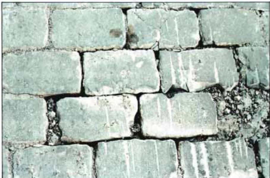
Detalle adoquinado primitivo en mal estado.
