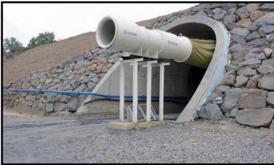
Figura 7.- Ventilador general de los túneles
