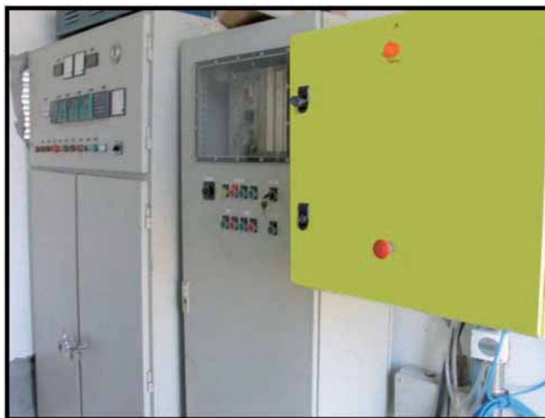
Figura 6.- Variador de frecuencia con control remoto.
