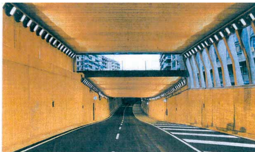
Figura 2. Carril de emergencia en el túnel de Badal. Barcelona
