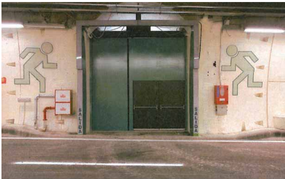
Figura 3. Salida de evacuación al exterior. Túnel Sur M-30. Madrid.
