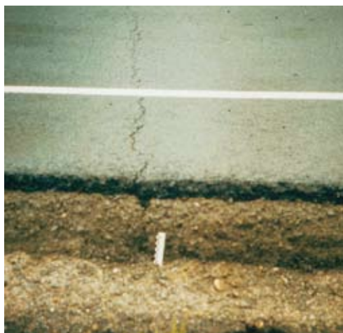
Figura 3. Reflexión de una fisura en la capa de rodadura.
