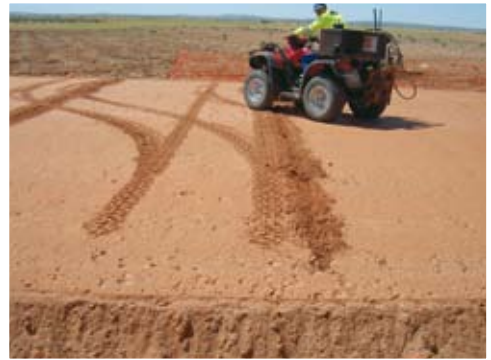
Ejecución del prefigurado, existe un sobrecancho de 30 cm, que se ve que no se prefisura.
