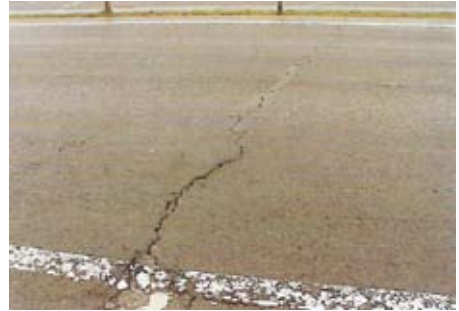
Fisura transversal reflejada en superficie.
