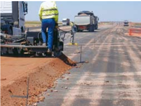
No eliminación del riego de curado.
