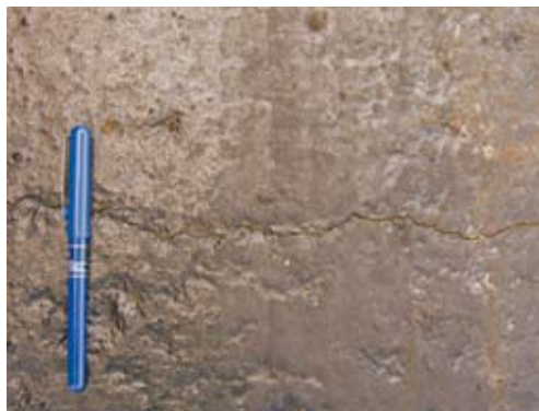
Foto 5. Detalle de fisura de retracción en coincidencia con junta.
