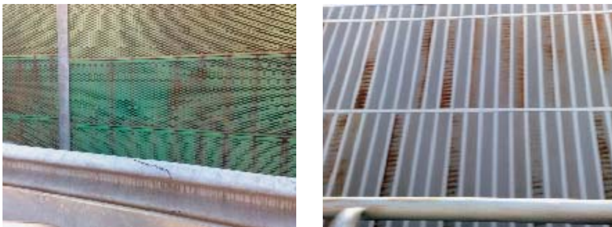
Figura 12: Ejemplos de deterioro de la durabilidad de dispositivos reductores de ruido.
