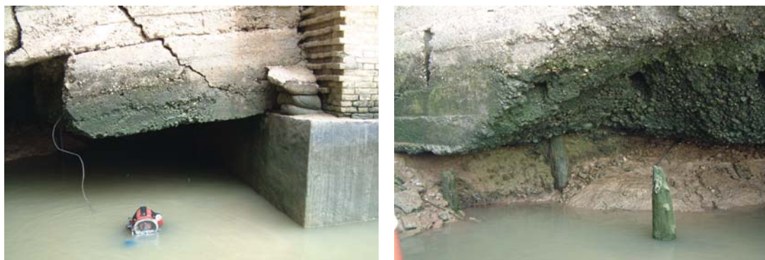
Figura 3.10. Cavity detectada bajo el muro lateral de un estribo gracias a la inspección subacuática.
