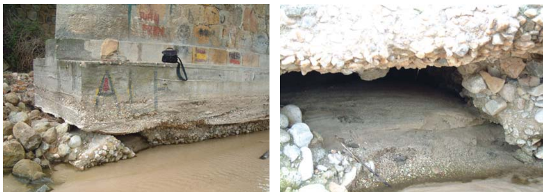
Figura 3.3. Socavación en una pila.
