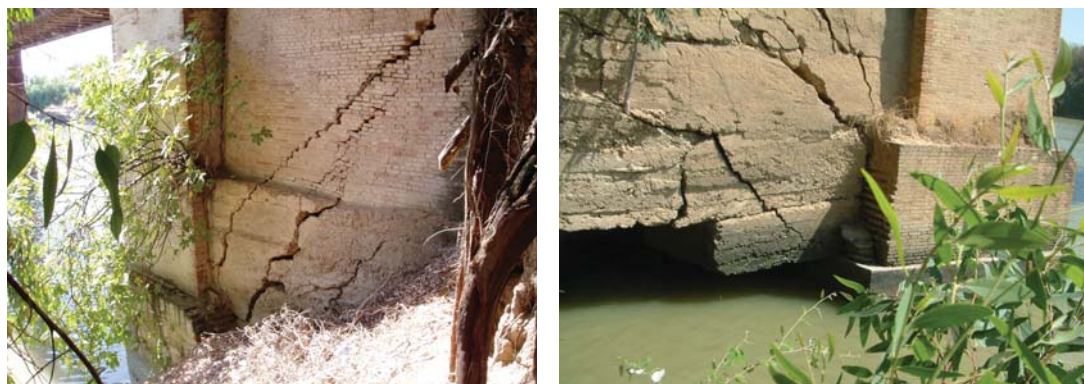
Figura 3.2. Daños en muros laterales de un estribo derivados de un descalce de la cimentación.
