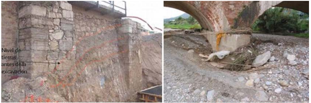
Figura 4.13. Izquierda, estratificación de material de sedimentación en las paredes de un estribo. Derecha, pila semienterrada por material de arrastre.
