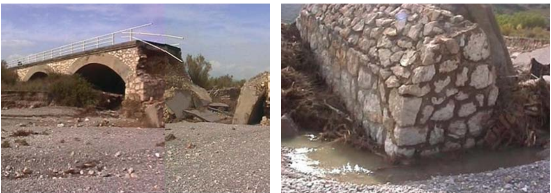
Figura 4.7. Colapso del puente de Cervera del Maestre sobre la Rambla Cervera en octubre de 2000, por socavación local de las pilas. Se aprecia el detalle de uno de los apoyos de mampostería basculado dentro de su fosa de socavación, así como restos de las bóvedas colapsadas que se sustentaban sobre dichos apoyos.
