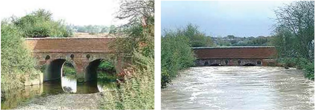
Figura 4.3. Ejemplo de puente de fábrica de capacidad hidráulica insuficiente al paso de una avenida, complicando la capacidad del cauce.
