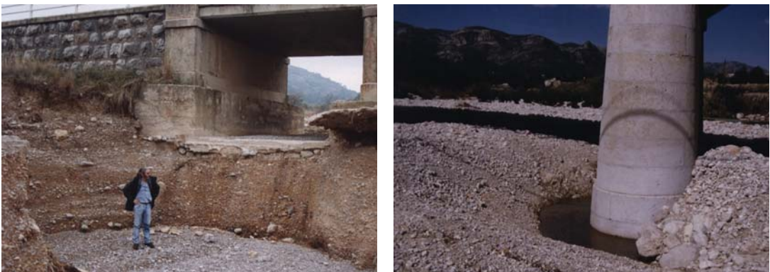
Figura 4.6. Diversos tipos de socavación local. A la izquierda, fosa de socavación, parcialmente rellenada tras el paso de la avenida, en el puente de La Serafina sobre la Rambla Cervera (Castellón). A la derecha, socavación asimétrica generada por el esviaje de la pila respecto al flujo, en un puente sobre el río Vernissa (Alicante).
