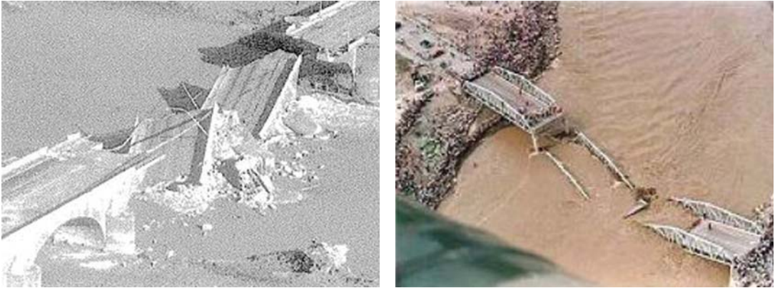
Figura 4.1. Colapso de dos puentes de diferentes épocas de construcción debidos a fenómenos de socavación. Izquierda, puente de fábrica sobre el río Llobregat en Molins de Rei [6] (1971). Derecha, puente metálico con pilas de hormigón [8].
